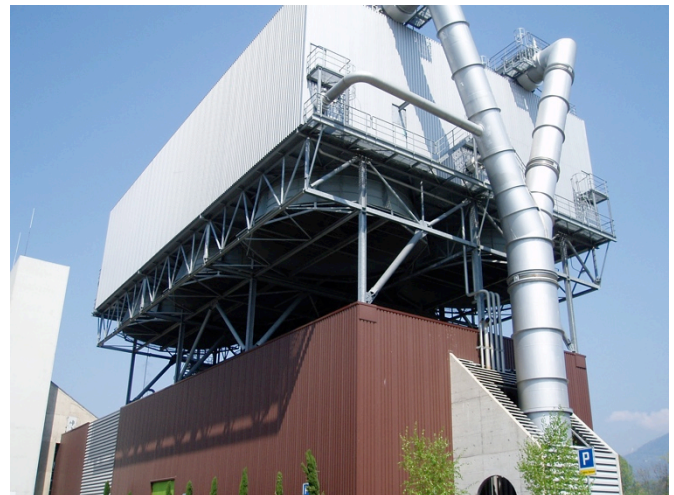
Abbildung 2: Luftkondensatoren – eine lohnende Investition zur Steigerung des Stromnutzungsgrades (SATOM)
