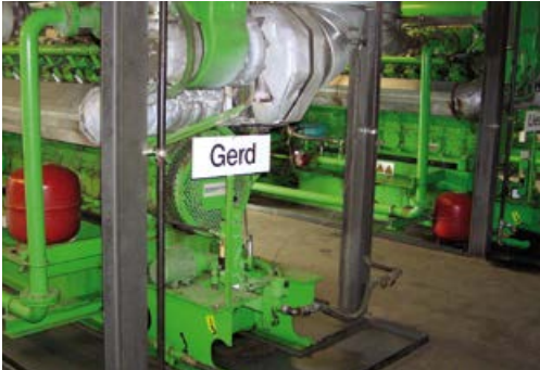
Gas engines for the biogas energy plant Försheim-Wicker Landfill
